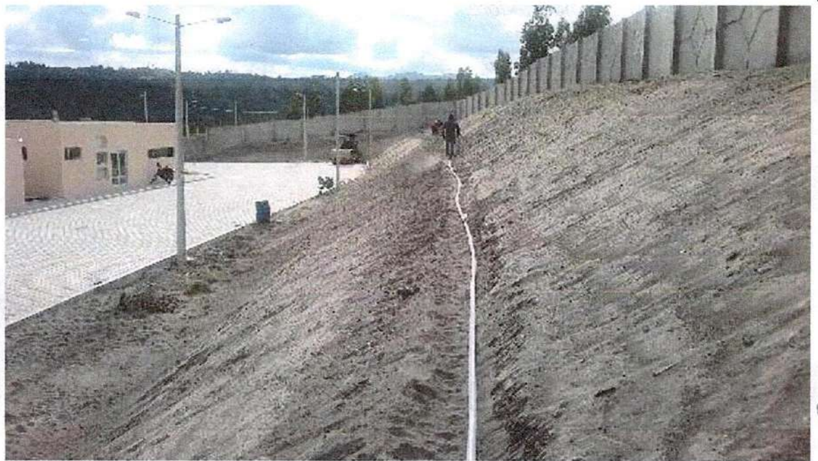
Sistema de riego, estabilización de taluds, centro gerontológico Guano
